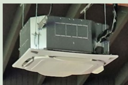
Nieuwe airco voor verwarming en koeling
